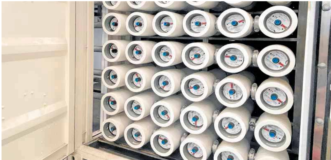
Vista interior de membranas de filtración montadas en bastidores de la desaladora de agua de mar. SUR
